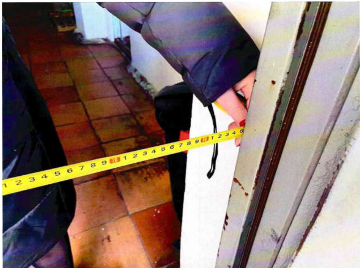
Рисунок 3.22 Ширина дверного проема на путях эвакуации 85 см
